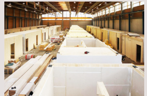
Die serielle Montage von Raummodulen im Werk erlaubt eine witterungsunabhängige Vorfertigung bei optimaler Qualität.
